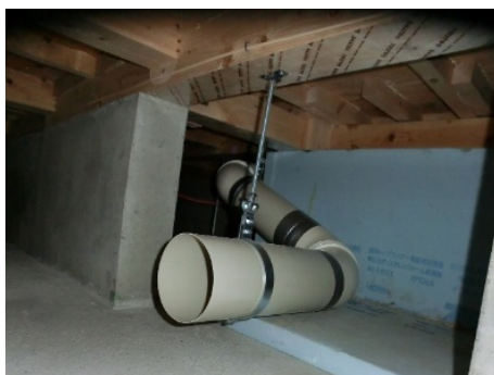
写真1 天井裏暖気導入用ダクト
