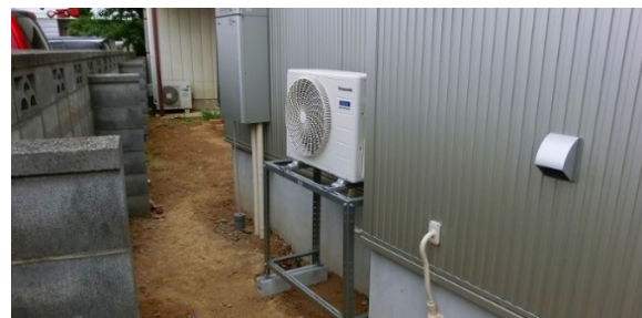
写真 設備機器は架台等で高い位置に設置
